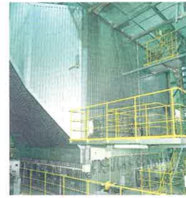
●電気集じん装置
