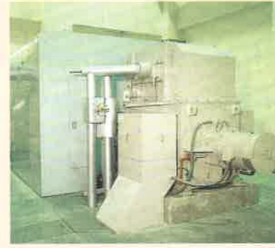
●タービン発電機
