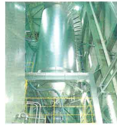
●有害ガス除去装置
